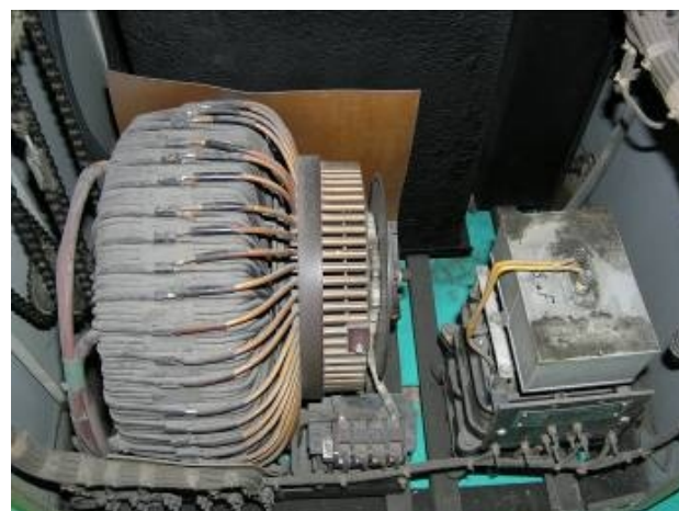
Obr. 6. Regulační autotransfornátor (foto: Fr. Filuš VŠB Ostrava).
